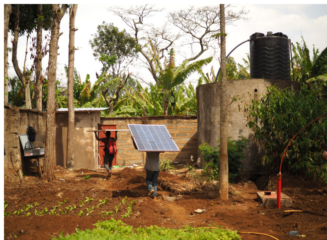
Anlieferung der Solarmodule für die SuMeWa 1 -Desinfektionsanlage.
