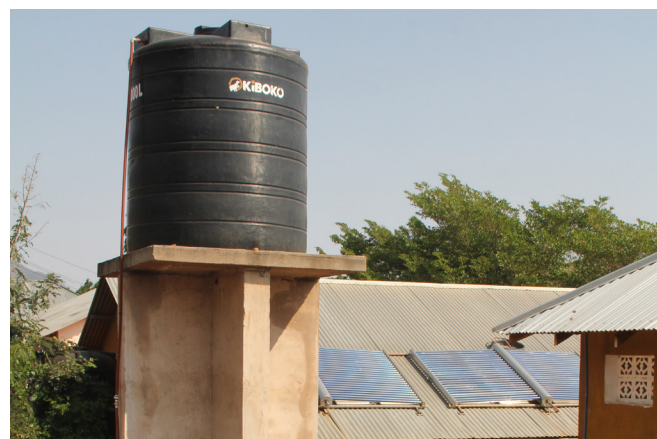
Bestehender Wassertank und SoWaDis-Anlage
