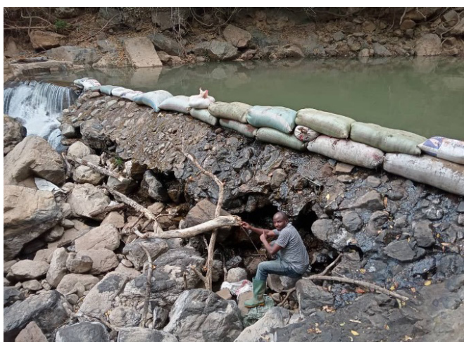
Die Ausgangslage – der in Mitleidenschaft gezogene Damm.
